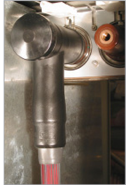
CB montert i Siemens bryter type 8DJ-10
