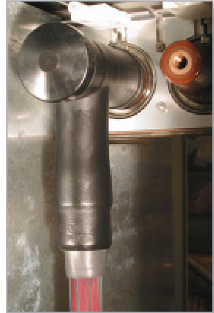
CB montert i Siemens bryter type 8DJ-10
